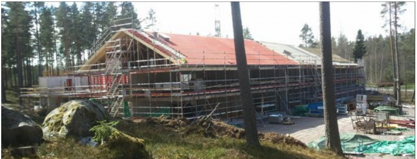
Elevförläggning P4, Kvarn © NCC Construction Sverige
